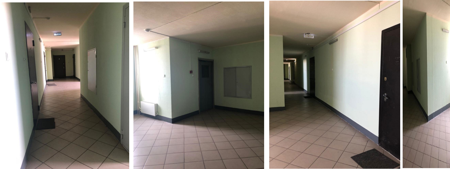
8) На 7-м этаже в квартирном холле, установлен отпавший верхний наличник у двери переходной лоджии.
